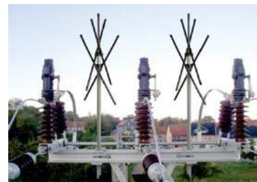
montiert auf Schaltermast
