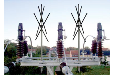
montiert auf Schaltermast
