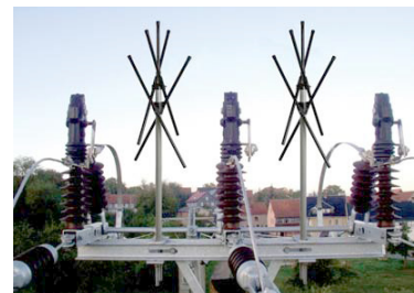
montiert auf Schaltermast
