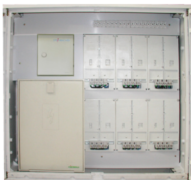
290389 (Abb. ohne Tür über Hauptsicherung)
