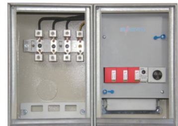
190293 mit montiertem Akustikmelder
